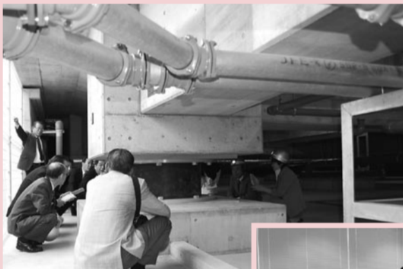
◀地震の横揺れ振動を低減する免震装置(積層ゴム32基)を設置した基礎部分
