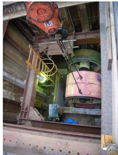
▲シールド工法による大和田新田地区浸水対策工事 平成 28 年
