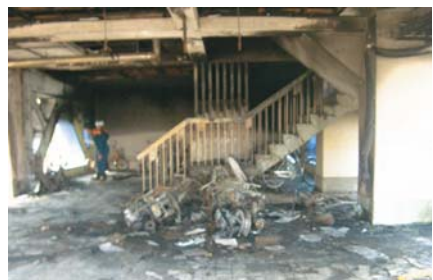
▲10月31日の火災現場
